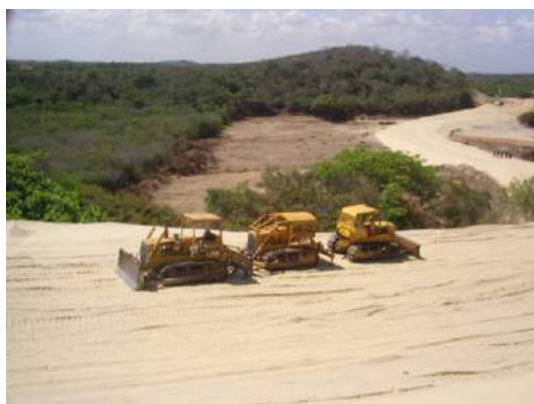
Figura 7 – Setor interdunar, associado a lagoa sazonal, desmatado e soterrado por sedimentos provenientes da degradação das dunas móveis e fixas (campo de dunas da Taíba). (Foto: J. Meireles, abril de 2008).
