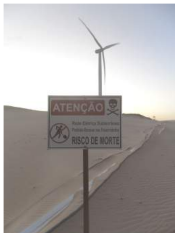
Figura 2 – Placa de risco de morte com cabos elétricos expostos, em Aracati/CE Fonte: arquivo pessoal, 2013
