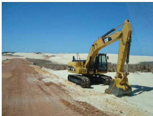
Figura 14 – leito estradal compactado para acesso de gruas e caminhões (campo de dunas Cumbe/Canoa Quebrada). (Foto: J. Meireles, outubro de 2009).
